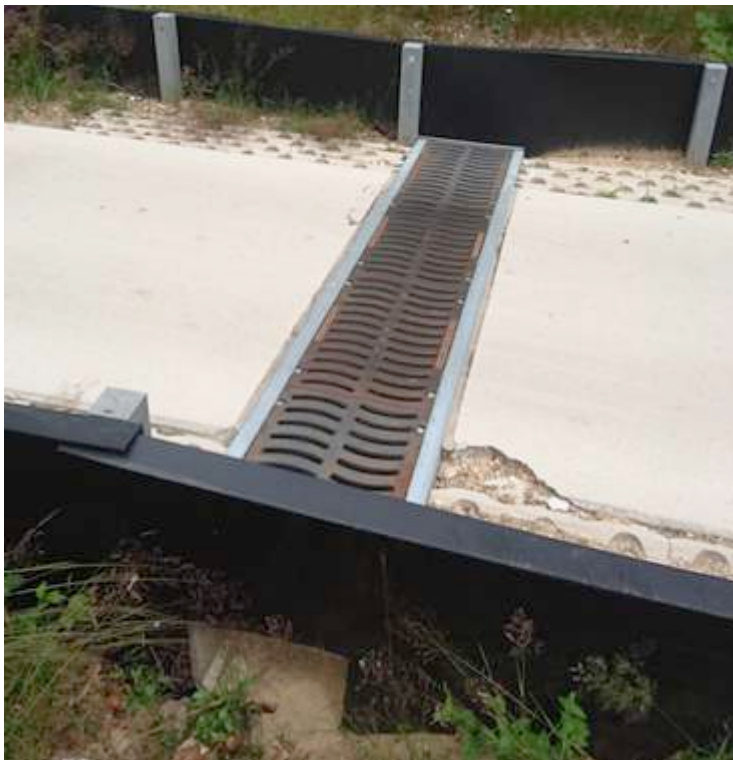
Figuur 1.2 Faunagoot en reptielenschermen langs het fietspad.
